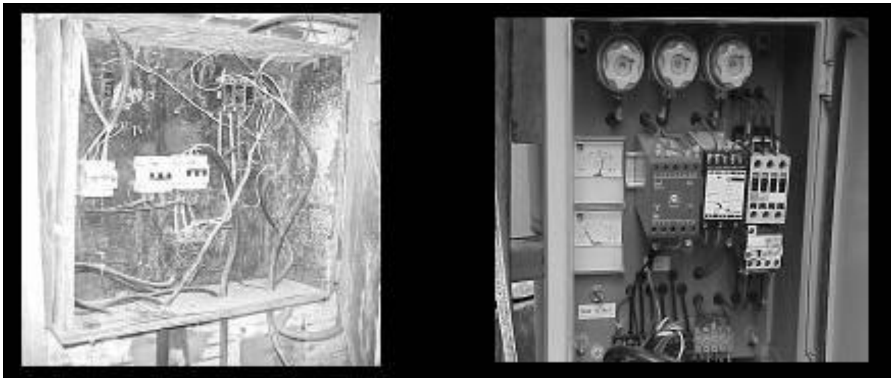
Figura 2 - Imagens de quadros de distribuição: A - desacordo as normas; B – conforme as normas
